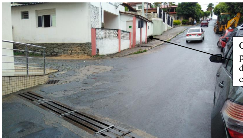
RUA DOMICIO MARTINS – PAVIMENTAÇÃO EM ASFALTO COM SUB BASE EM PARALELEPIPEDO – DEMOLIR
