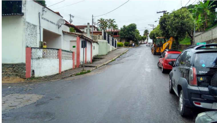
RUA DOMICIO MARTINS – PAVIMENTAÇÃO EM ASFALTO COM SUB BASE EM PARALELEPIPEDO – DEMOLIR
